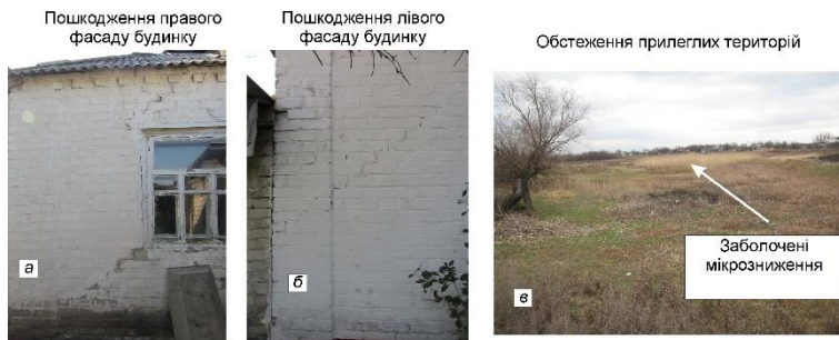
Рис. 3. Приклад поетапного аналізу інженерно-геологічної та гідрогеологічної інформації: а, б – обстеження будівлі з фіксацією пошкоджень, в – обстеження прилеглих територій
